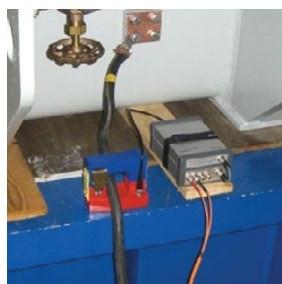
Exemple de câble de terre d'un TCHF sur un transformateur de puissance
