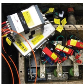
Exemple d'utilisation d'un TCHF dans un coffret de permutation
