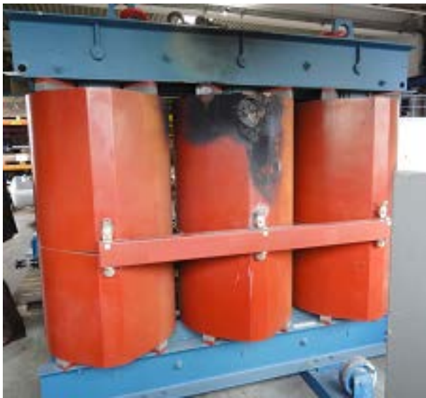
Abbildung 7. Fehler für Durchschlag an Gießharztransformator
