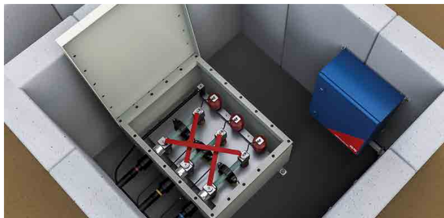
Die Betongehäuse schützen die HFCT-Sensoren und das Datenerfassungsgerät gegen Grundwasser und Staub.
