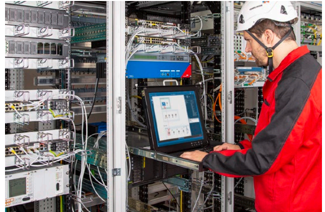
Figura 3: StationGuard importa el archivo SCL (System Configuration Language - lenguaje de configuración de subestaciones) de la subestación para crear un modelo completo del sistema
