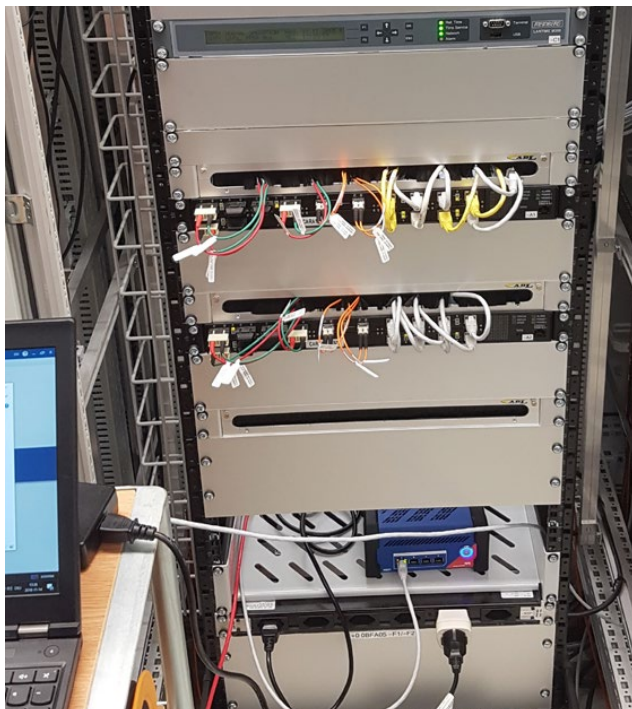
Рис. 4. Пилотная установка на подстанции 110 кВ компании СКВ
