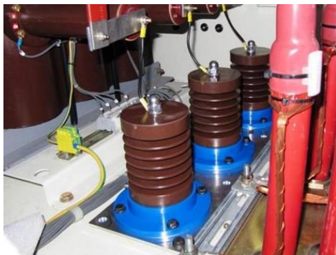
Figure 7 : Mesure en ligne avec condensateurs de couplage installés
