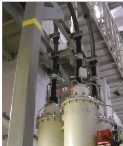
Концевые муфты кабельной системы 380 кВ, проложенной в грунте
