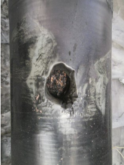
Пробой изоляции концевой муфты кабеля
