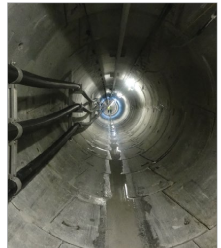
Соединительные муфты кабельной системы 380 кВ, проложенной в туннеле
