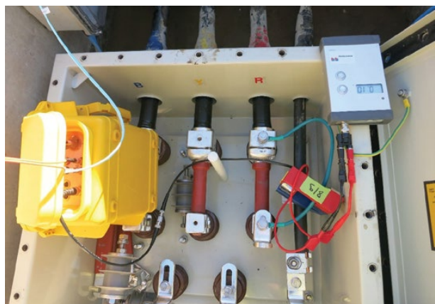
Verbindung im Schaltkasten der Auskreuzverbindungen
