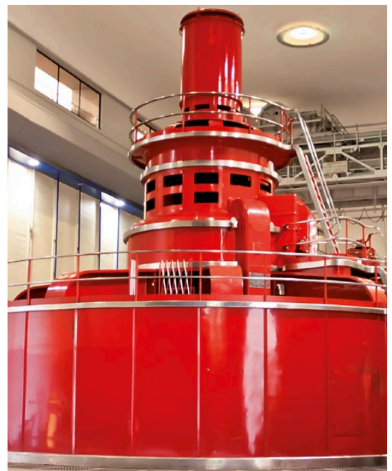
Generatoren sind wichtige Komponenten in der Stromversorgung. Informationen über den Isolationszustand helfen dabei, Ausfallzeiten effektiv zu verhindern.
