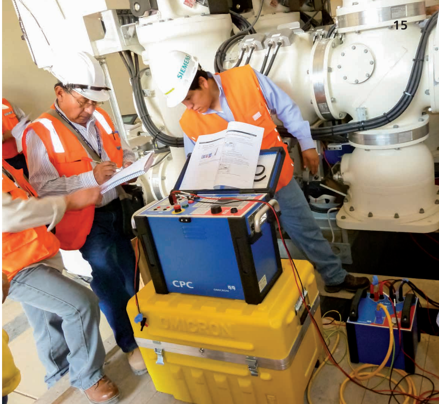
Prueba de una GIS de tipo 8DN8-4 de 72,5kV con un sistema de prueba CPC 100 + CP RC.
