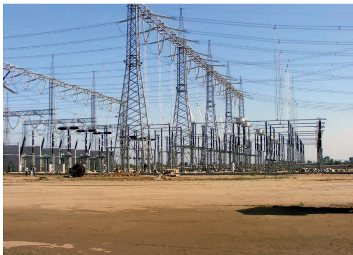
Subestación tipo intertemperie 500/220/132kV en Pakistán puesta en servicio con CPC 100.
