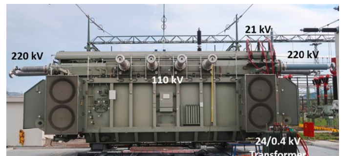
Figure 1 Vue du transformateur de 300 MVA
