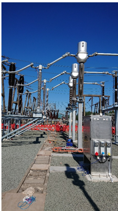
图 7：使用 CPC 100 进行测试，其中通过传统和非传统变压器来驱动测试电流
