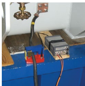
Ejemplo de cable de tierra de un HFCT en un transformador de potencia
