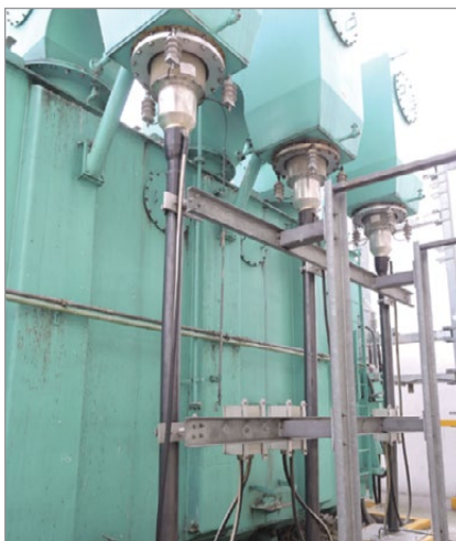
Terminaciones de un sistema de cables cortos de 230 kV
