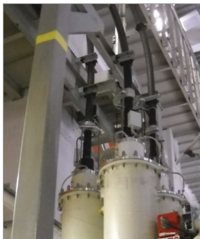
Terminaciones de un sistema de cables enterrados de 380 kV
