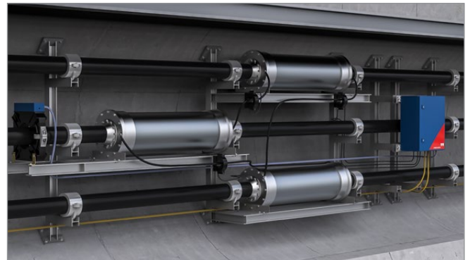
Monitoreo de DP en los empalmes de pantalla cruzada de un sistema de cables tendidos en túneles
