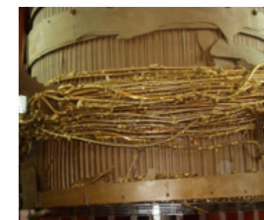
分接绕组塌陷
