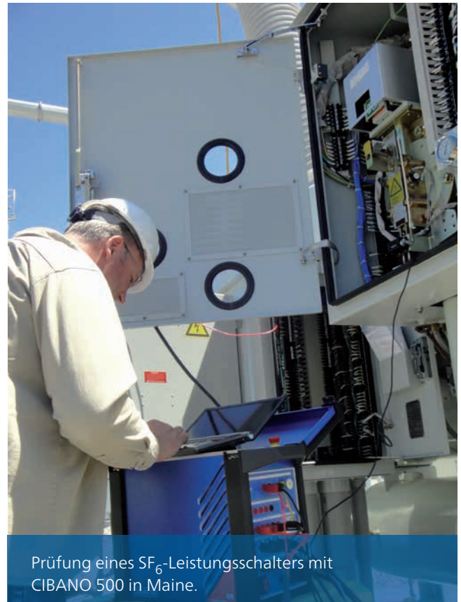
Messung eines Hochspannungsleistungsschalters (Live-Tank-Ausführung) in Österreich.
