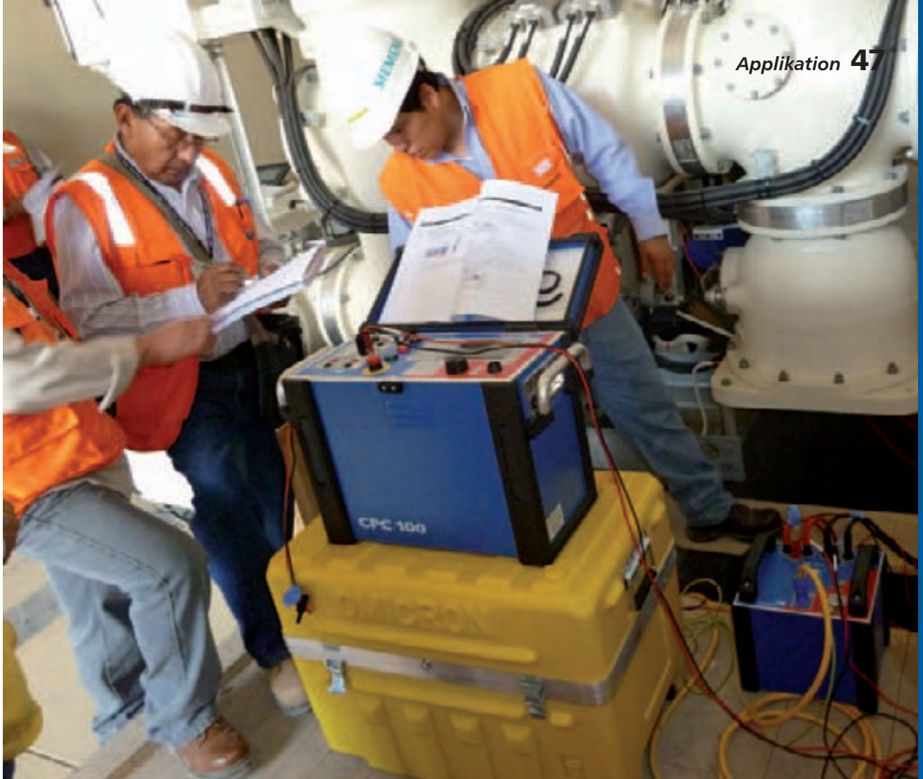
Erster Projekteinsatz in Peru: Eine neue 72,5 kV-GIS wird mit Hilfe des CPC 100 und dem Resonanzkreis CP RC getestet.
