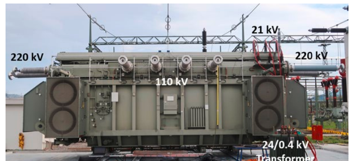
Abbildung 1 Ansicht des 300-MVA-Transformators
