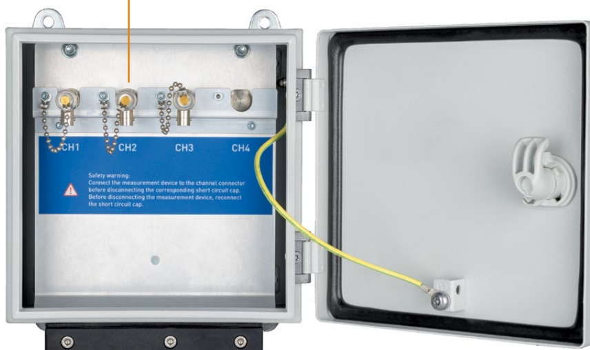
Vista frontal - gabinete aberto
