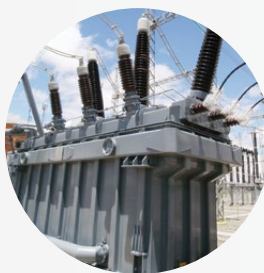
Transformateurs de puissance
