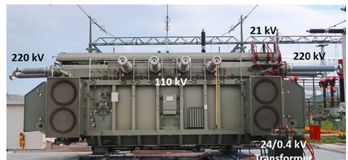
Figura 1 Vista del transformador de 300 MVA
