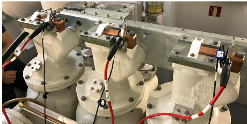
Bild 17 - 245 kV GIS-Anlage mit je einem eigenen Gehäuse pro Phase.
