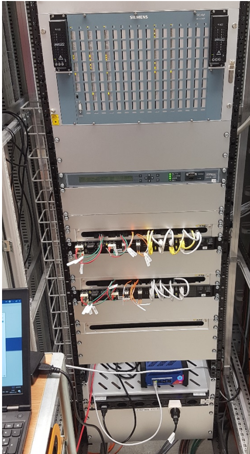
Abbildung 3 Installation mit der mobilen Plattform MBX1 von StationGuard in der 110-kV-Anlage der CKW
