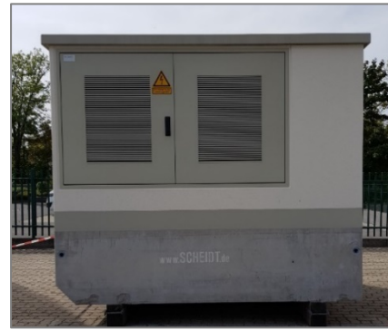
Figura 4 Subestación secundaria estándar de SÜC
