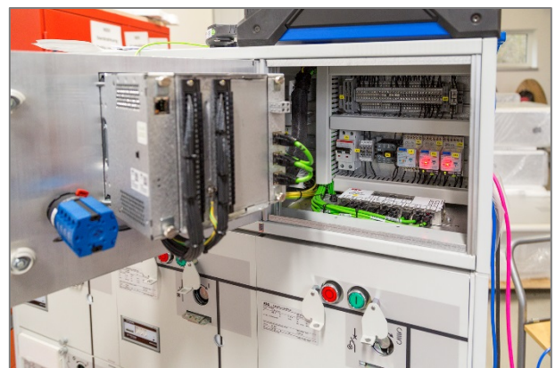
Figura 8 Adaptadores de prueba de sensores ABB en el compartimento de baja tensión
