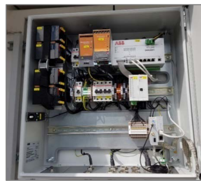
Figura 5 Señalización y control a distancia con un equipo FIONA de ABB
