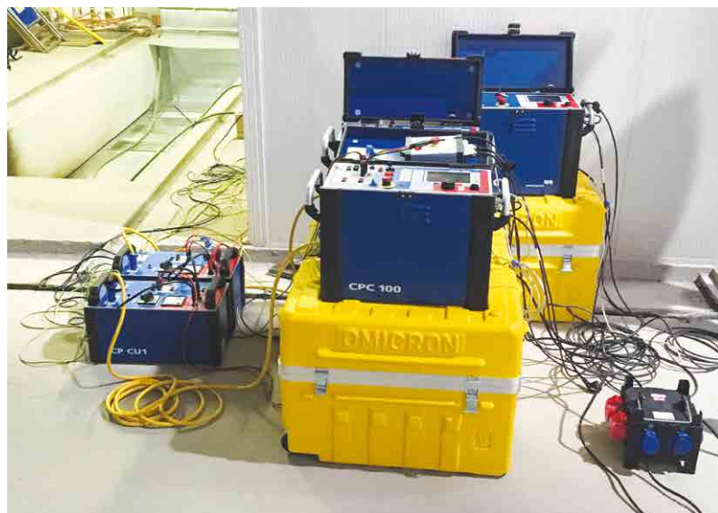
Drei CPC 100 mit CPC Sync und drei Anpasstransformatoren wurden für die Erregung der Trockentransformatoren eingesetzt.
