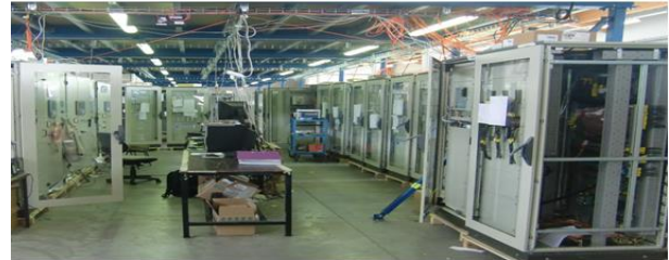
Image 4 : Test complet en usine d'un système de protection et de contrôle-commande numérique interconnecté
